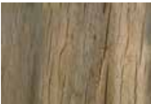
شکل ۱۴-۱- ترک های سطحی در تخته
