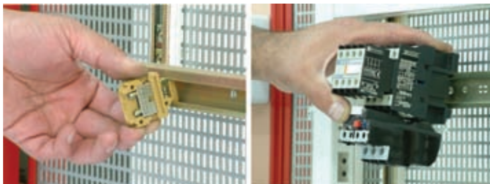
شکل ۵-۶۷ نصب کنتاکتور و ترمینال روی ریل
