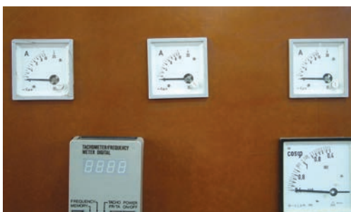
شکل ۱۱-۶- آمپرمترهای اندازه‌گیری جریان فازها
