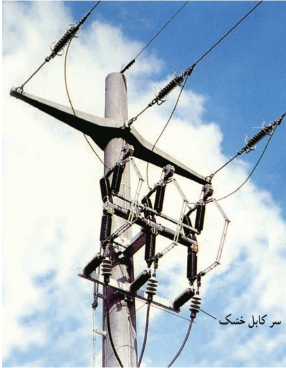
شکل ۶-۶- سر کابل خشک حرارتی هوایی
