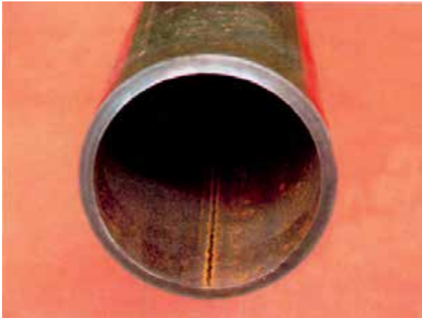
شکل ۲-۱۳- لوله‌ی برقو خورده
