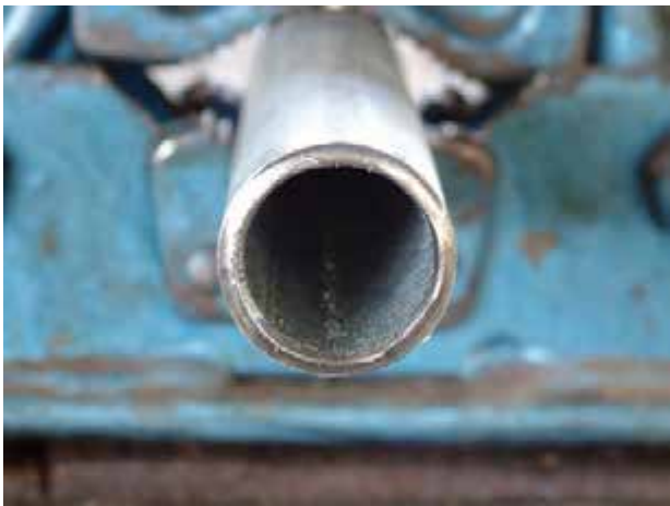
شکل ۲۰-۲- لوله‌ی برقو خورده
