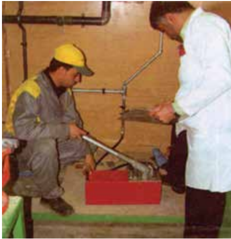
شکل ۵-۹۳- نحوه‌ی آزمایش با پمپ آزمایش دستی
