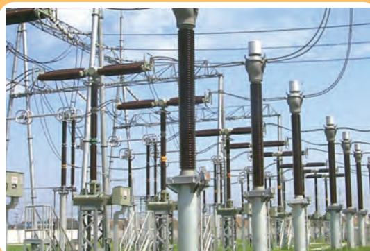
پست تقویت ولتاژ جریان برق
