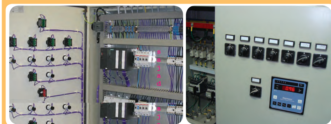
تابلوهای برق صنعتی موجود در کارگاه‌ها
