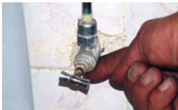
شکل ۱۴۷-۲- کنترل نشت آب از محل اتصال
