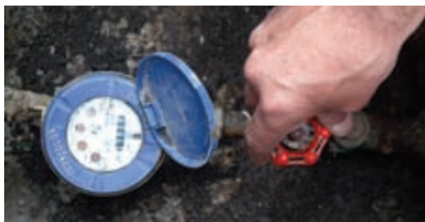
شکل ۱۴۰-۲- بستن شیر فلکه‌ی اصلی
