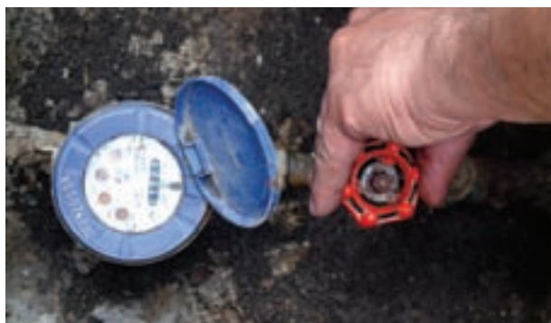
شکل ۱۹۷-۲- بستن شیرفلکه‌ی اصلی
