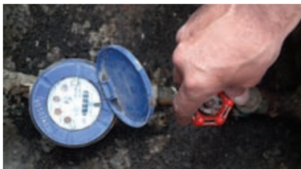
شکل ۲-۱۸۱- بستن شیرفلکه‌ی اصلی
