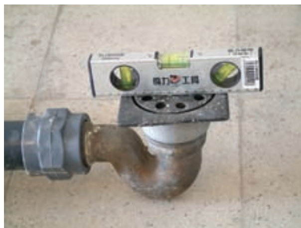
کف‌شوی نصب شده بر روی سیفون شترگلی
