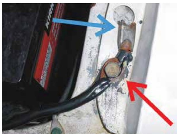
شکل ۳۷-۲- اتصال غلط کابل باتری به بدنه
