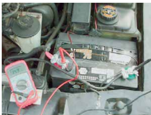
شکل ۷-۱۰۲- اندازه‌گیری ولتاژ شارژ
