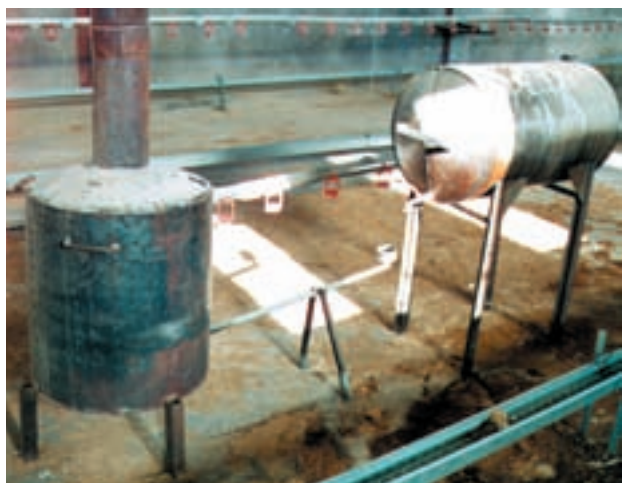
تصویر نوعی بخاری داخل جایگاه که کنترل حرارت به وسیله آن مشکل است و احتمال آتش‌سوزی در آن زیاد است.
