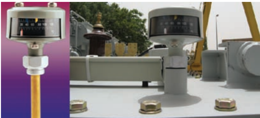
شکل ۲۳- ترمومتر ساده کنتاكت دار و محل نصب آن روی مخزن ترانسفورماتور
