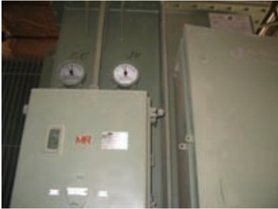
شکل ۲۵- محل نصب ترمومتر سیم پیچ و روغن روی یک نمونه ترانسفورماتور
