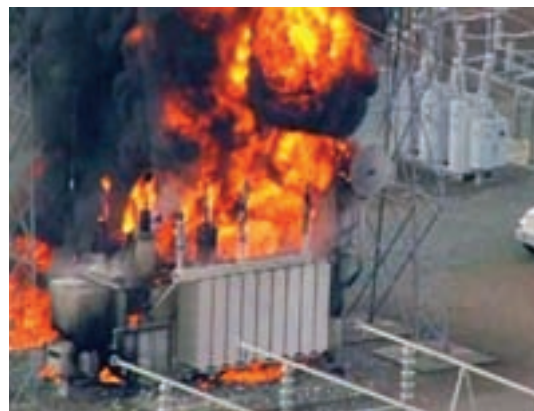
شکل ۲۰- انفجار ترانسفورماتور قدرت
