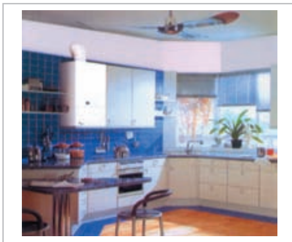
شکل ۶-۱۴- نمای یک دستگاه شوفاژ دیواری
