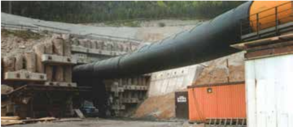
شکل ۳۶-۲- لوله‌های فلزی تهویه با اتصالات جوشکاری شده
