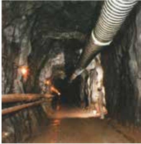
شکل ۳۲-۲- کاربرد لوله‌های تهویه
