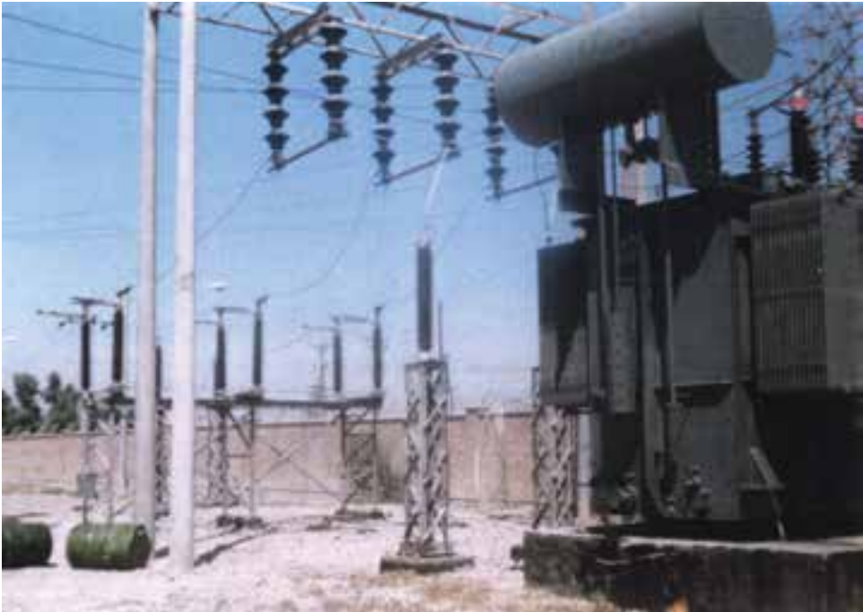
شکل ۵-۸ - قسمتی از یک پست اصلی برق
