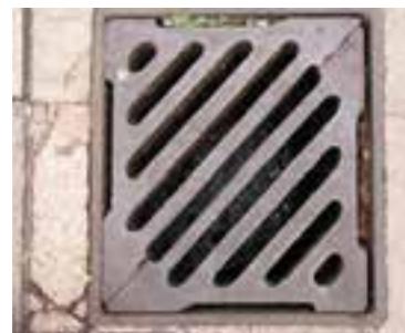
شکل ۱۰-۲ درب چاه های شهری از چدن
