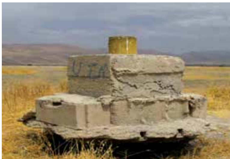
تصویر ۸-۴- پدیده فرونشست زمین (منطقه خانمیرزا)
