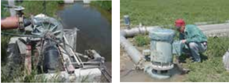
شکل ۱-۲- پمپ در حال انتقال آب تحت فشار به سیستم‌های آبیاری
