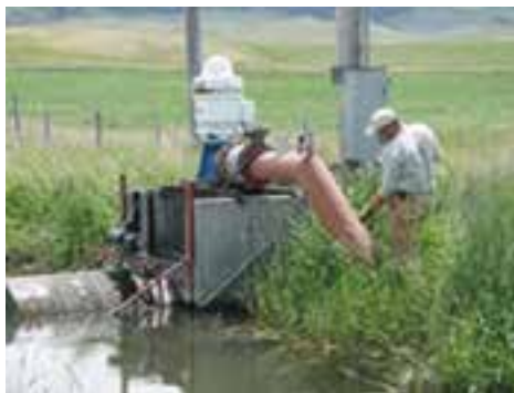
شکل ۱-۱- پمپ در حال انتقال آب از کانال
