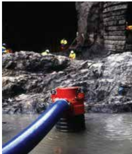
شکل ۱-۳- پمپ زهکش در حال کار
