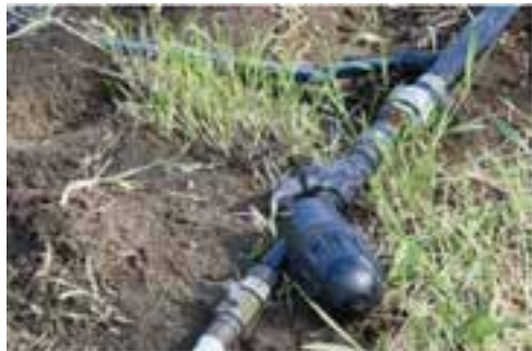
الف) فیلتر در مسیر شبکه آبیاری
