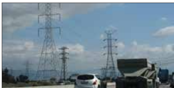
▲ شکل ۱-۵- انتقال انرژی الکتریکی توسط دکل‌ها
