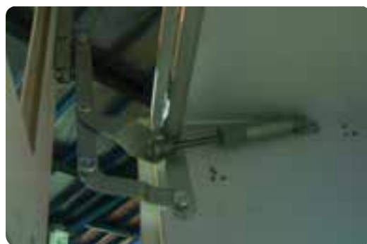
شکل ۶-۳۸ در کابینت نصب شده با جک اتوبوسی
