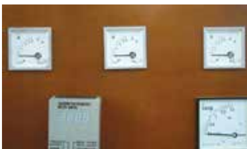
شکل ۱۱-۶- آمپرمترهای اندازه‌گیری جریان فازها
