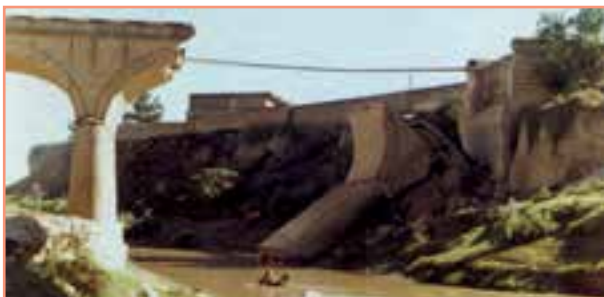
شکل ۱۷-۶- تخریب یک پل ارتباطی بر اثر سیل
