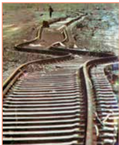
شکل ۶-۶- تخریب خط آهن بر اثر وقوع زلزله
