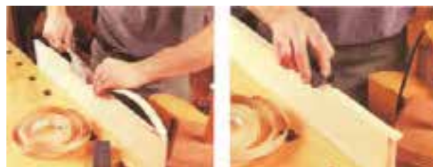
شکل ۱۴۴- برای چسباندن لب‌چسبان‌هایی از جنس روکش طبیعی یا مصنوعی، می‌توان از اتو استفاده کرد.
