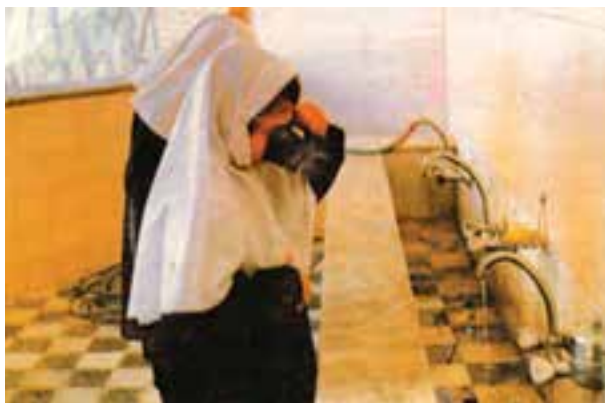
شکل ۲-۵۹- چکه کردن شیر آب
