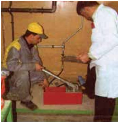
شکل ۵-۹۳- نحوه‌ی آزمایش با پمپ آزمایش دستی
