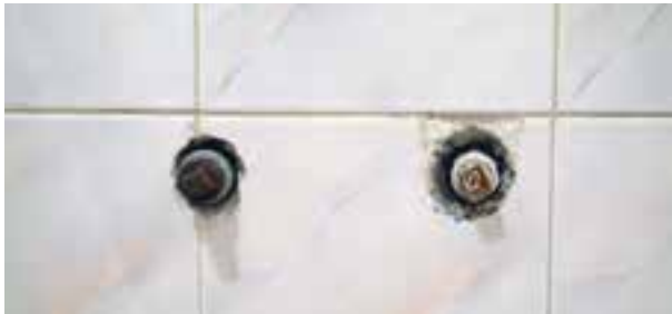
شکل ۳-۴۷ لوله‌های آب سرد و آب گرم محل نصب شیرهای پیسوار
