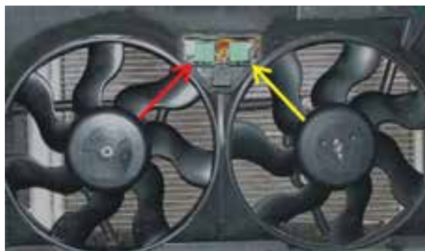
شکل ۱۱-۶- رله ی فن ها
