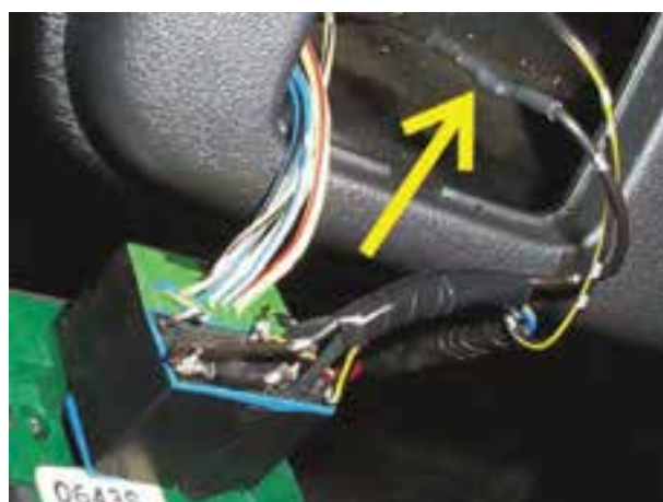
شکل ۱۹۴-۲- عایق‌کاری سیم مدار الکتریکی
