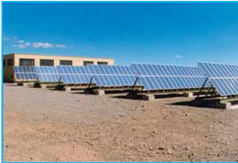
شکل ۹- نیروگاه خورشیدی واقع در روستای حسینیان (استان سمنان) بخش تحقیقاتی انرژی‌های نو وابسته به سازمان انرژی اتمی ایران
