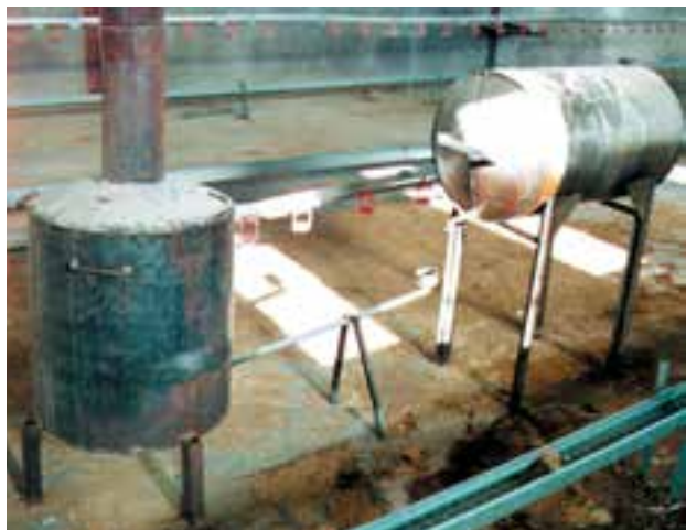
تصویر نوعی بخاری داخل جایگاه که کنترل حرارت به وسیله آن مشکل است و احتمال آتش‌سوزی در آن زیاد است.
