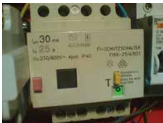
شکل ۱-۱۸- فیوز حفاظتی نصب شده در کارگاه
