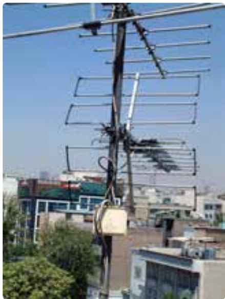
شکل ۱۹-۴ میکسر و محل نصب آن روی دکل آنتن
