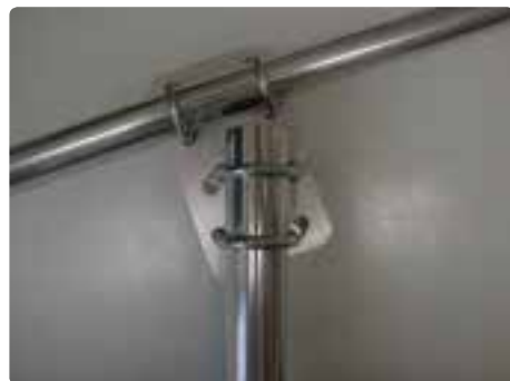
شکل ۴-۸ لوله نگه دارنده آنتن
