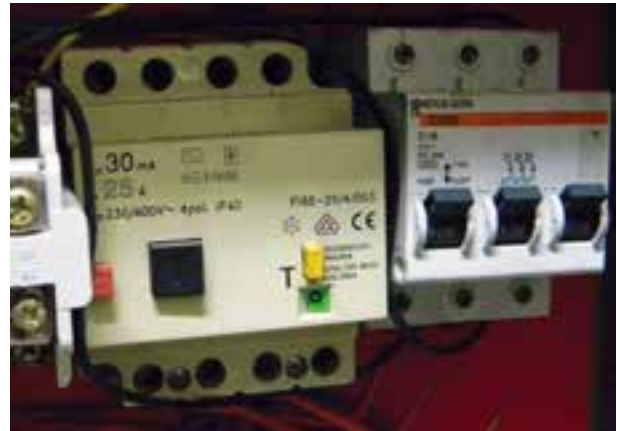
شکل ۱-۵ فیوز حفاظتی نصب شده در کارگاه
