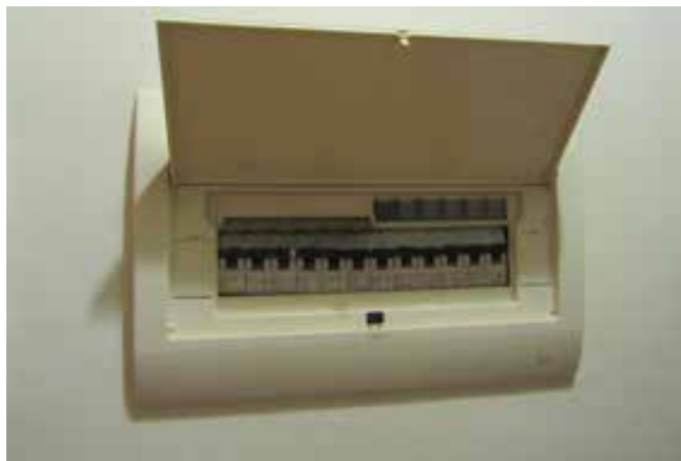
الف) تابلو برق تک فاز
