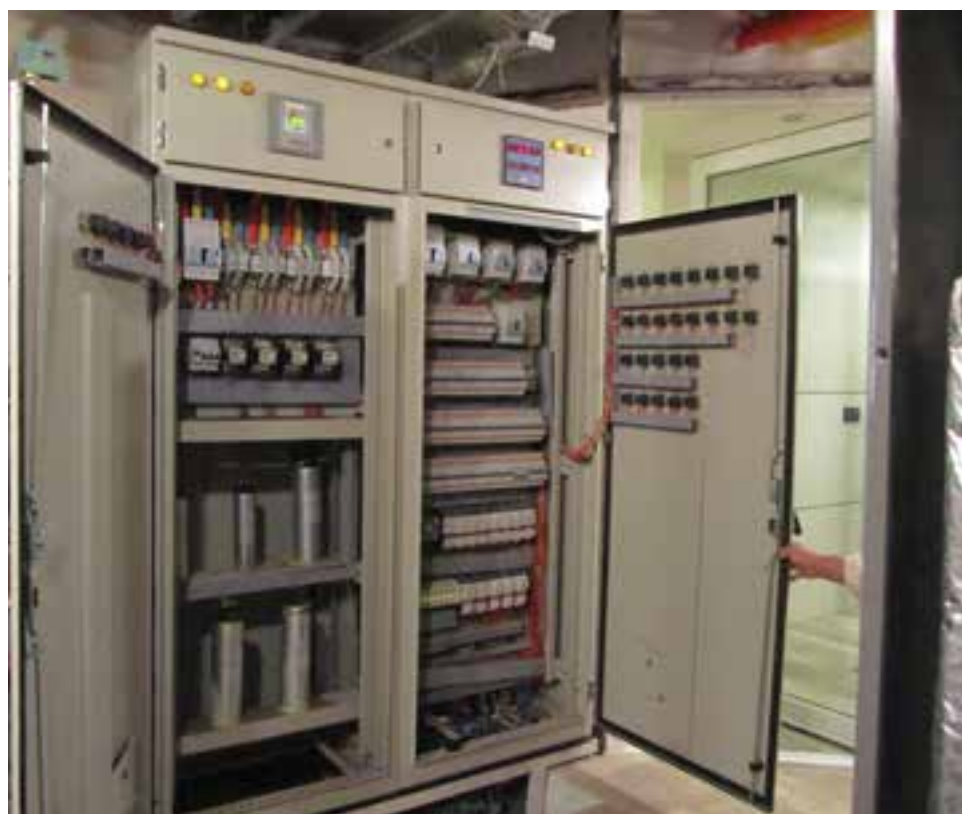
ب) باز شده تابلو برق
