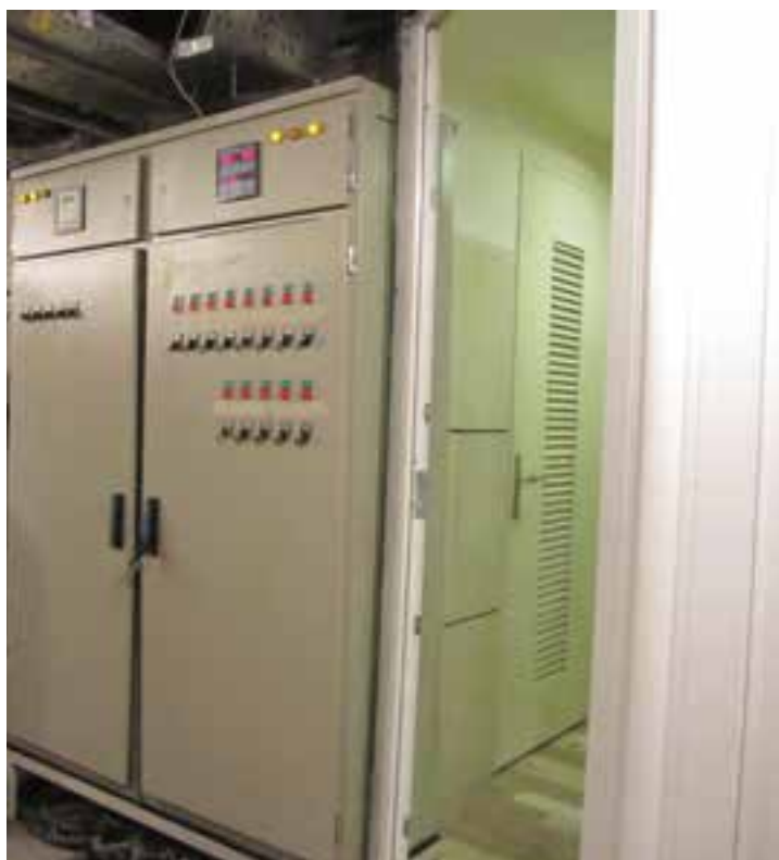
ب) تابلو برق سه فاز
