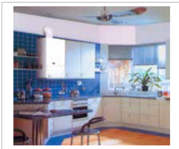
شکل ۶-۱۴- نمای یک دستگاه شوفاژ دیواری
