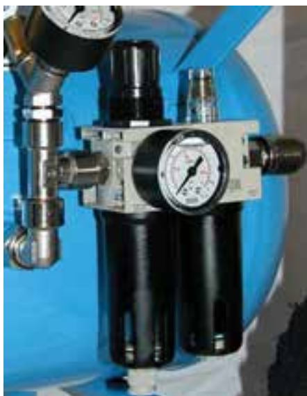
شکل ۱۳-۱- فشارسنج روی مخزن پمپ باد
