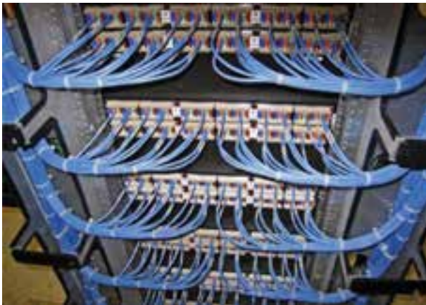
شکل ۲۸-۴- کابل کشی پشت پانل پچ پانل Loaded Patch Panel
