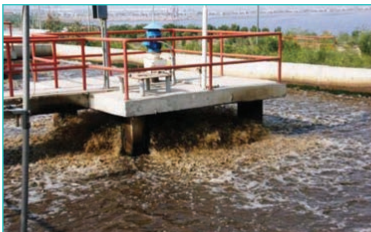
شکل ۵-۶- تصفیه‌خانه فاضلاب ارومیه
