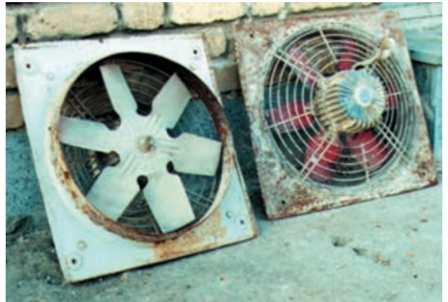
تعویض هواکشهای خراب و فرسوده
