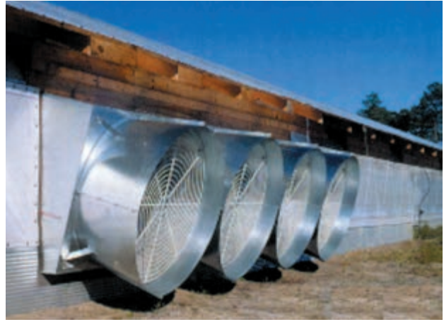
نمای هواکشها از بیرون جایگاه
