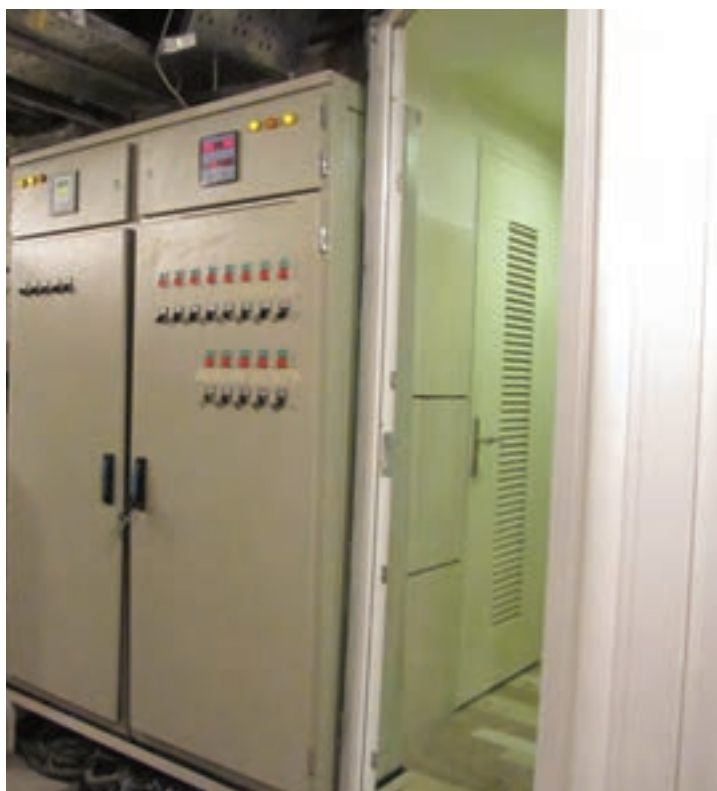
ب) تابلو برق سه فاز
