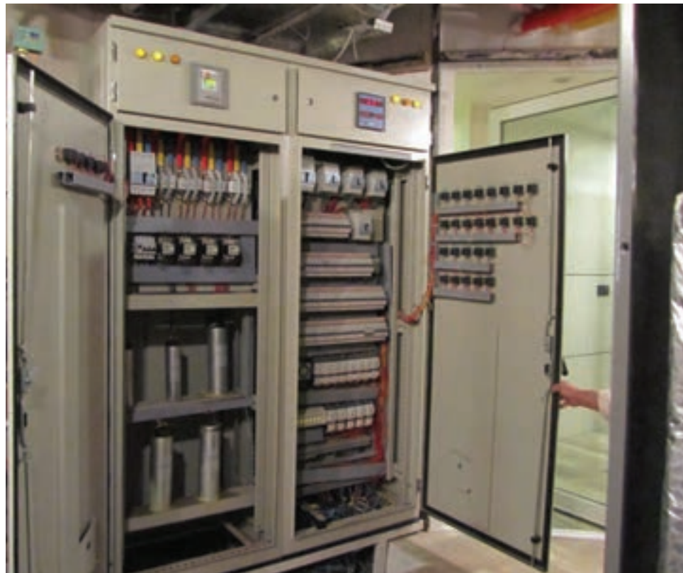
ب) باز شده تابلو برق
