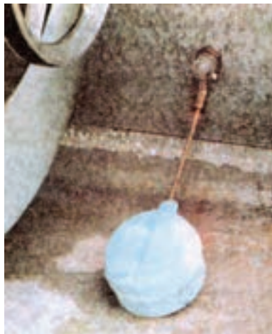
ب) یک فلوتر نصب شده
