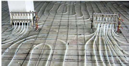
شبکه‌ای از لوله در کف گلخانه برای عبور آب گرم و ایجاد گرمایش
