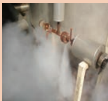
نشستی از اتصال در خط لوله
