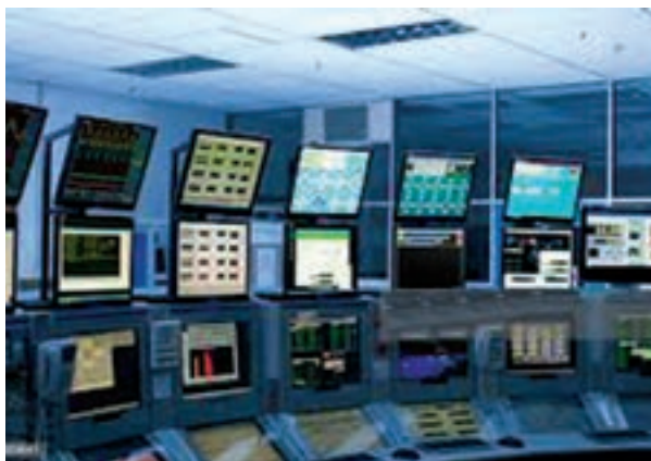
شکل ۲۸- نمایی از اتاق فرمان واحد
