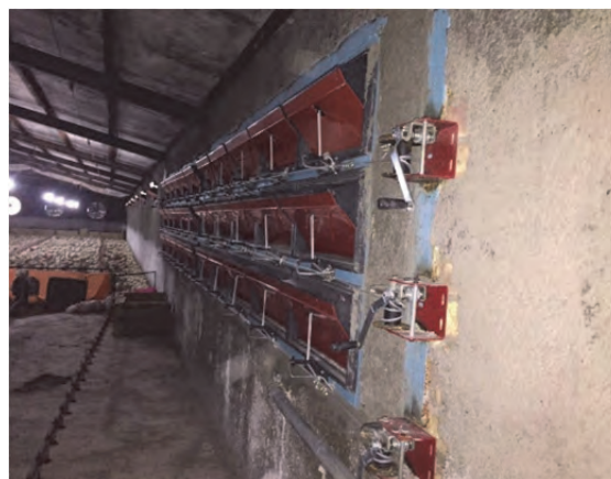
ورود هوا از طریق پنجره‌های خودکار (اینلت)
