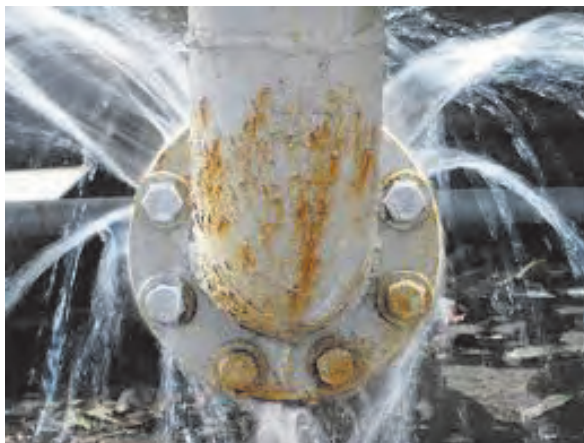
شکل ۲۴-۵. نشست آب بر اثر ضربه قوچ
