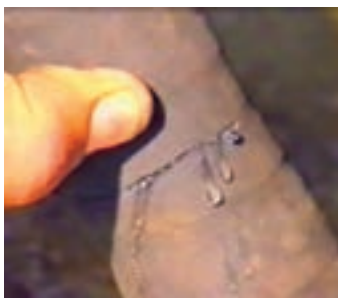
شکل ۶. نشتی از شیلنگ ها
